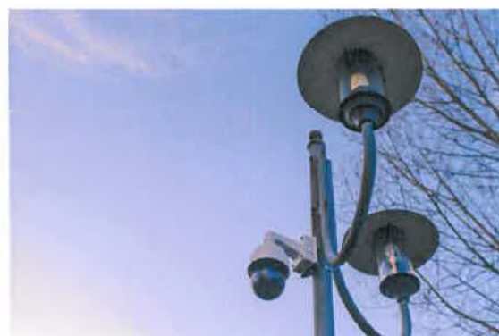
Fot. 22. Rozbudowa monitoringu o oprogramowanie do analizy obrazu wraz z wdrożeniem do Systemu oraz Monitoringu Wizyjnego.
