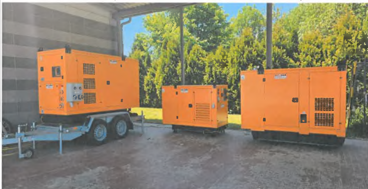
Fot. Agregaty prądotwórcze z przyczepą transportową (archiwum Urzędu Miasta)
